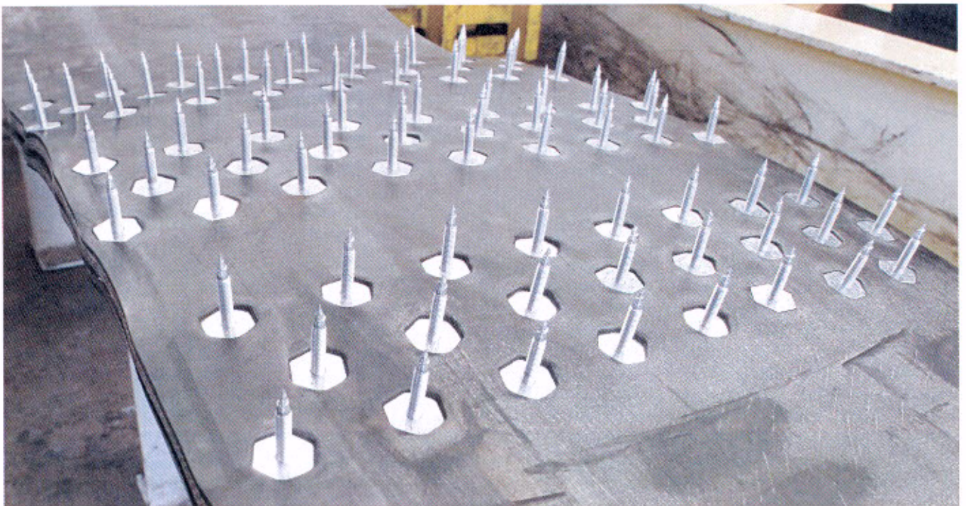
Abb. 2 Die Fördergurtverbindung im Anlieferungszustand Rückseite
